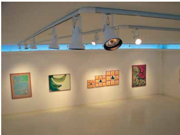
Trilhos eletrificados, de 12V, abrigam spots direcionáveis para iluminação das obras.
