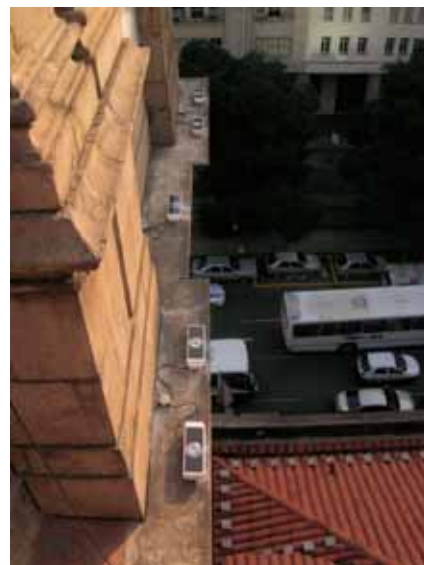
Projetores instalados sobre a cornija, na base das torres.
