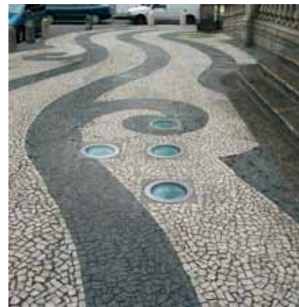
Projetores embutidos no chão, na fachada frontal.
